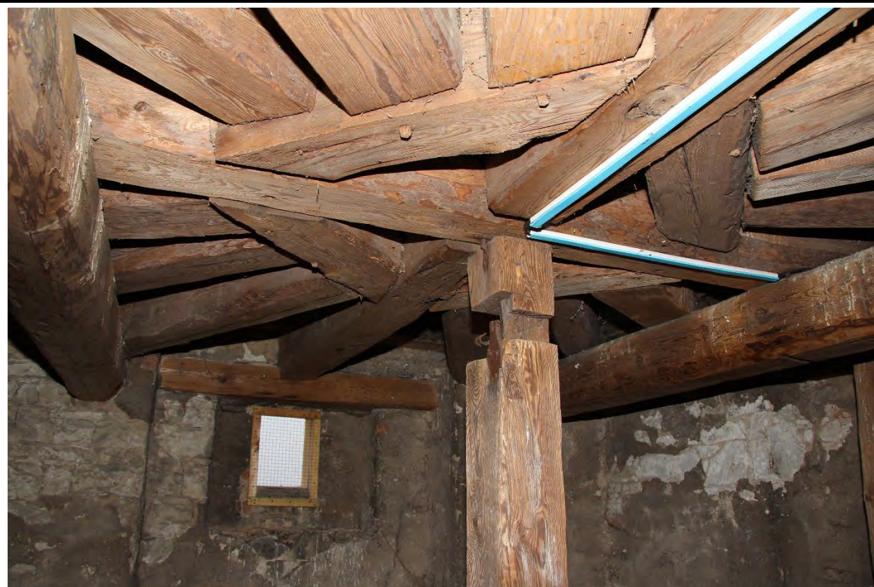
Trámový rošt krovu věže v pohledu z interiéru hodinového patra. Foto: Jaroslav Skopec, 2019.
