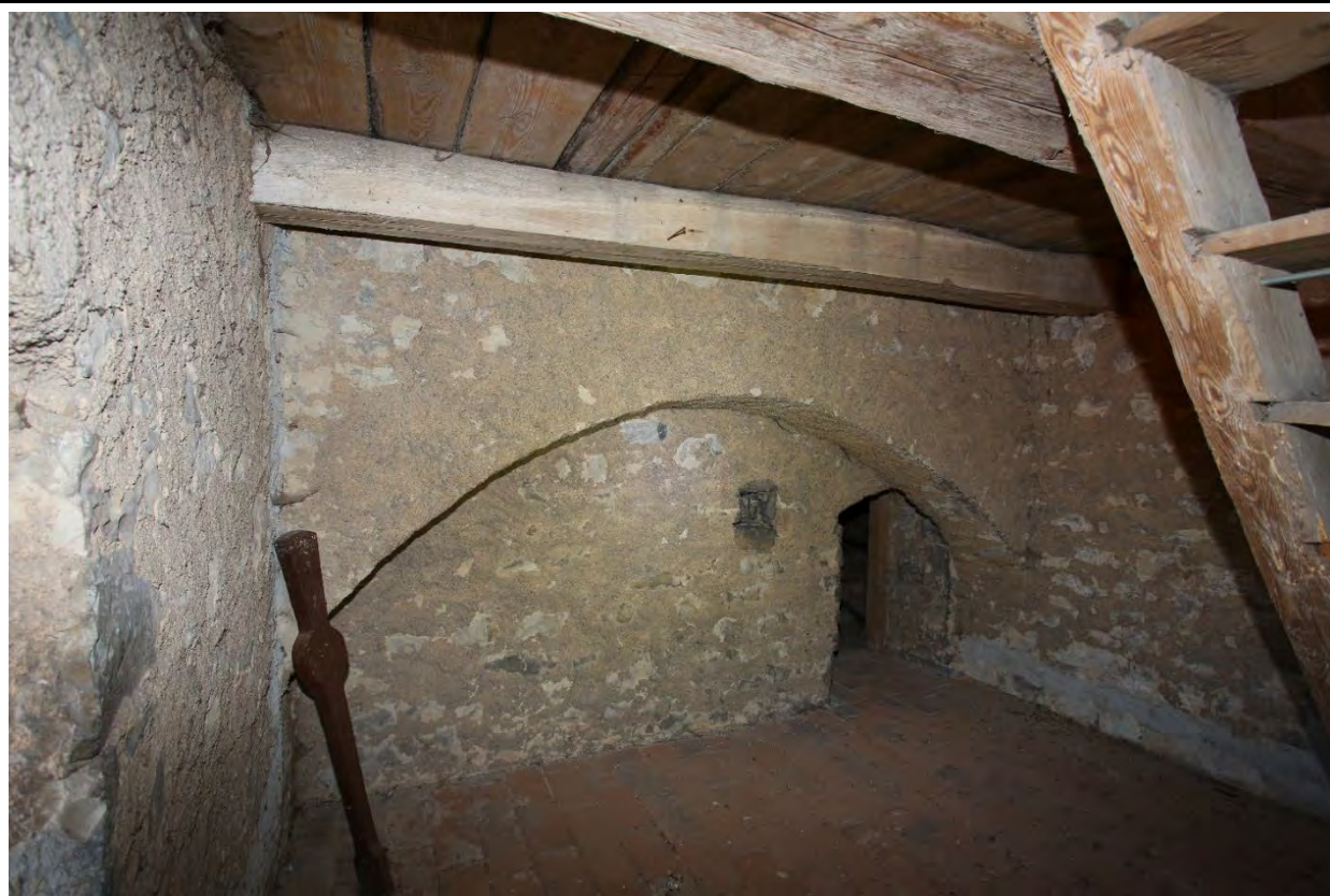
Interiér druhého patra věže v pohledu od severovýchodu ke vstupu do krovu. Foto: Kateřina Neumannová, 2015.
